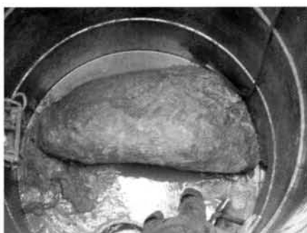
写真-5 立坑内巨大転石
